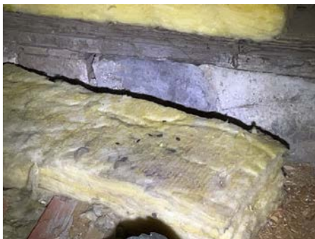
Foto viser muselort e.l. på isolasjon som har falt ned fra himling.
