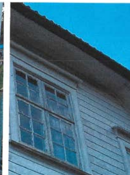
Vindu enkelt glass som e modent for utskifting.
