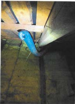
Eks på kanal ikke ført over tak.
