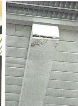
Lekkasjemerker i innboksing i klasserom i 1. etg.
