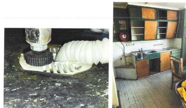
Sluk i gulv under dusjkabinett. Belegg går ikke ned i sluken.
