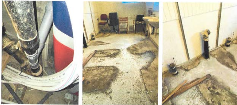
Støpejern og plast avløpsrør. Rust på støpejerns rør.
