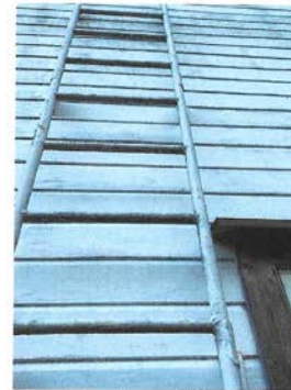
Rømningsstige er ikke godkjent etter dagens forskrift. Råte i kledning
