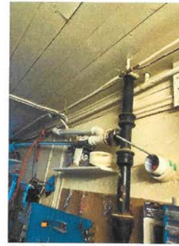
Støpejern og plast avløpsrør om hverandre. Rust på avløpsrør i støpejern.
