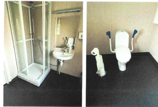
Bad i 1. etg. Ikke fall på gulv. flatt gulv.
