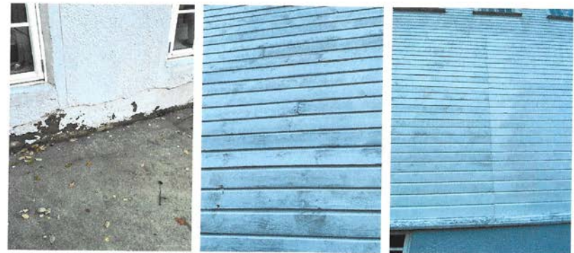
Murpuss har løsnet
