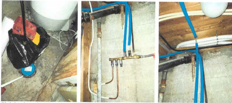
Sluk i gulv ved VVB er blendet. Noe stål, kobber og plast vann rør.
