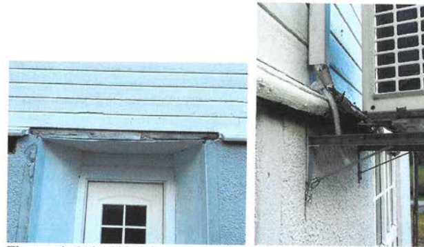
Eksempel på råte i kledning, samt dårlig Råte i vannstokk avslutning rundt dør.
