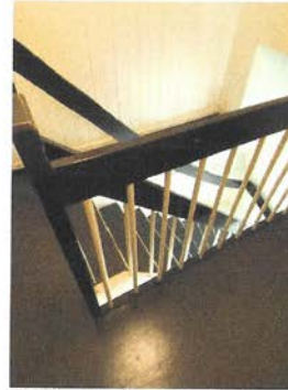
Rekkverk på trapp med større åpninger og lavere høyde enn dagens krav
