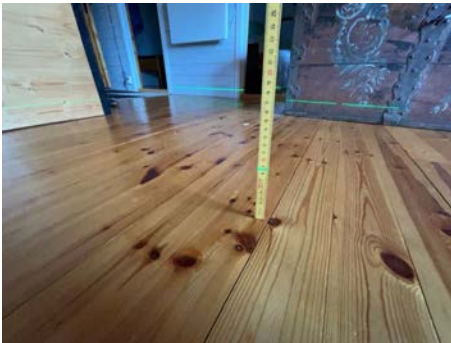
Utkastrek på laser er 11 cm på målestokk. Bilde viser ca. 25 mm høydeforskjell innefor 2 meter i stue.
