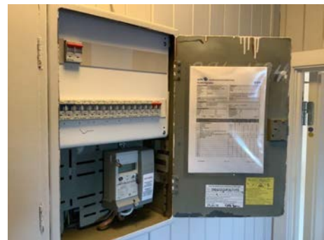
Sikringsskap står montert i felles trapperom.
