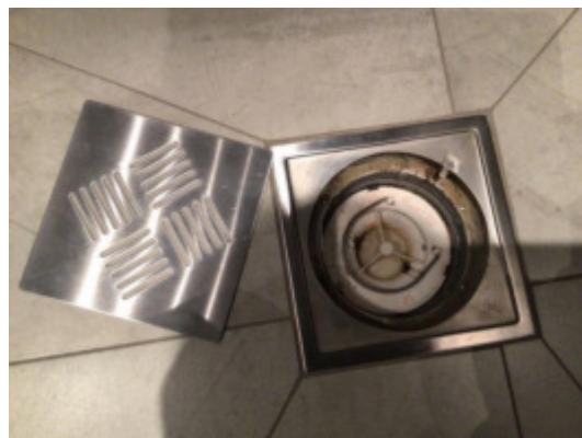
Sluk i gulv.
