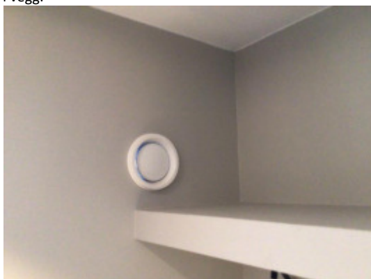
Eksempel på ventil i vegg.
