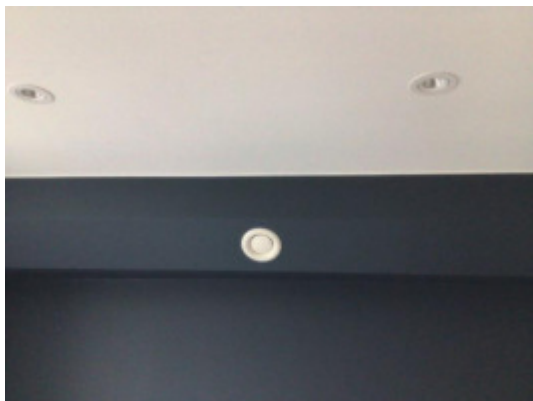
Ventil i vegg.
