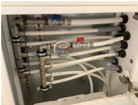
Kontrollskap på bad.
