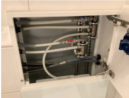
Kontrollskap på toalettrom.
