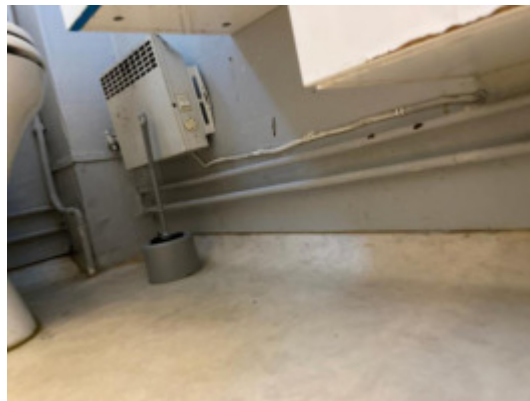
Synlige rørføringer på badet.
