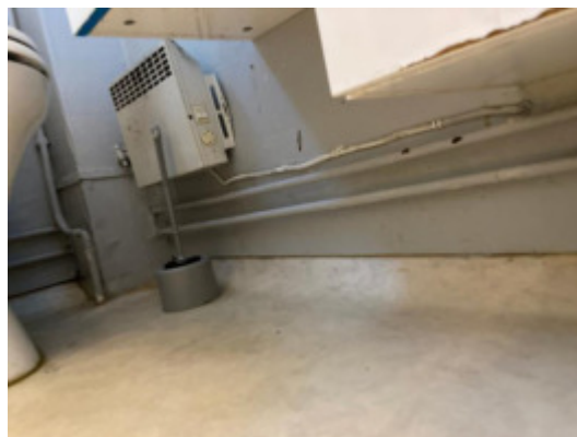
Synlige rørføringer på badet.
