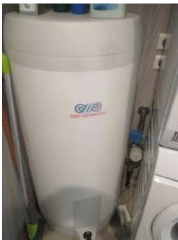
Bereder er plassert på bad/vaskerom.
