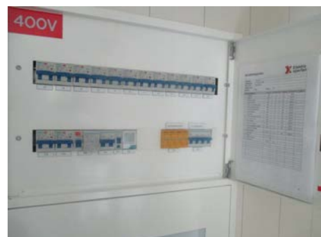
Sikringsskapet er plassert i bod andre etasje.
