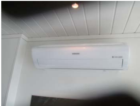
Varmepumpe i stue.
