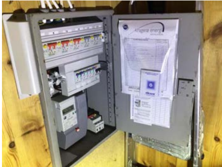
Sikringskap i trapperom ned til kjeller.
