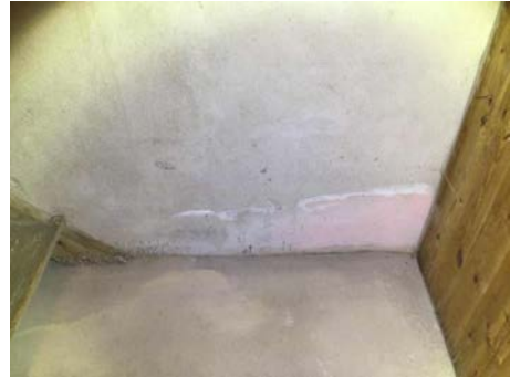
Eksempel på saltutslag.
