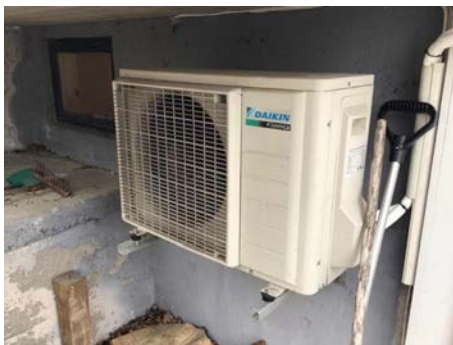
Varmepumpe Ytter del.
