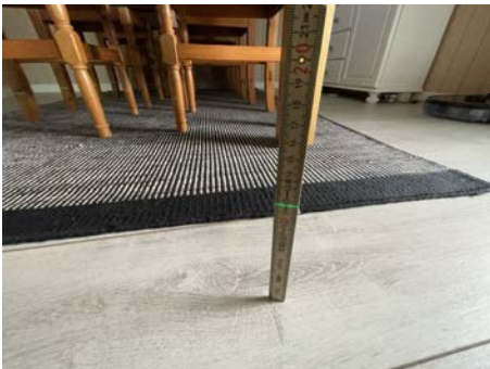
18 mm. skjevhet registrert på en avstand på ca. 2 m.
