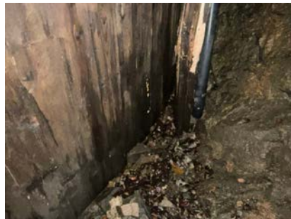
Nedløp fra takvann er ikke ført i rør ved grunn.
