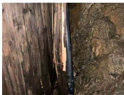
Skade på søyle synlig fra vindu i bod i underetasjen. Høy fuktighet i område.
