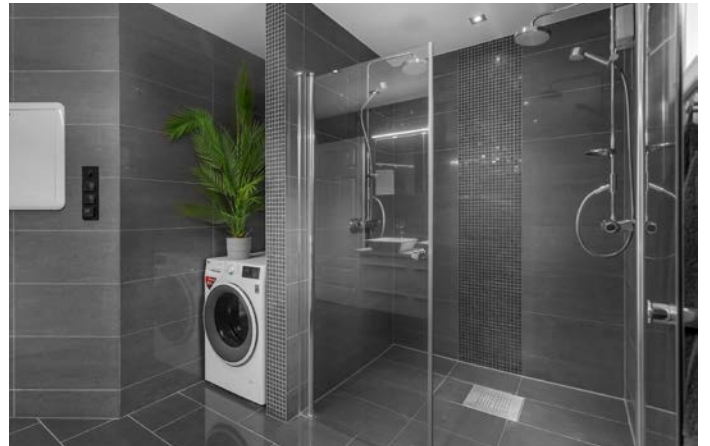
Opplegg for vaskemaskin i rommet.
