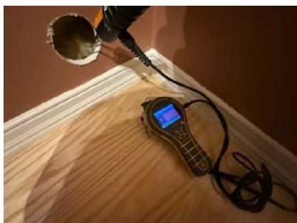
Forhøyede fuktverdier ved måling.
