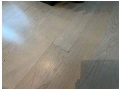
Ne slitasje på laminatgulv enkelte steder.
