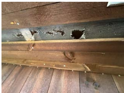
Hull i flueduk i gesims.
