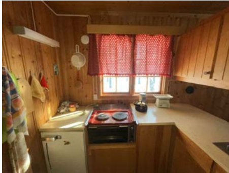
Avtrekk mangler over kokesone.
