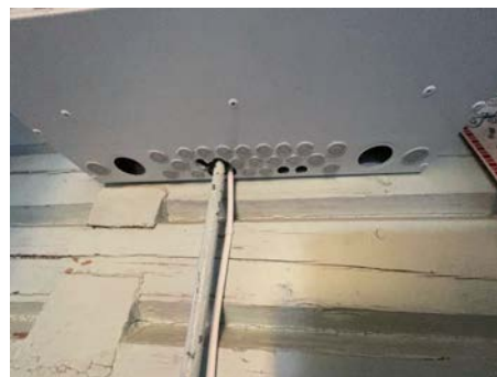
Bilde viser eks. på hull/åpninger i sikringskap
