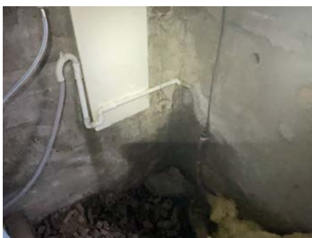
Bilde viser avløp som føres direkte til grunnen i grovkjeller
