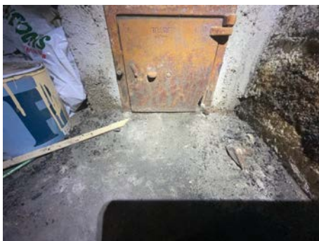
Bilde viser defekt sot-/feieluke, nedre hengsle mangler.
