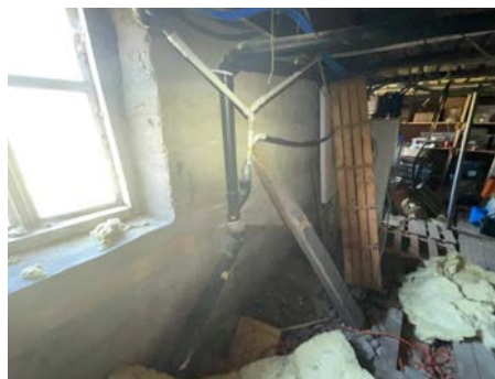
Bilde viser tapet rørkobling
