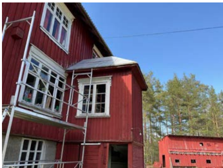
Bilde viser manglende takrenner og nedløp på trappehus.
