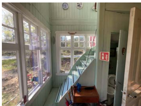
Bilde viser eks. på manglende håndløper og rekkverk
