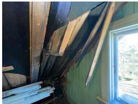
Bilde viser skade i takkonstruksjon
