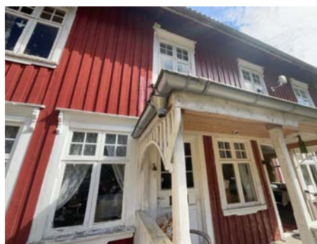
Bilde viser eks. på manglende nedløp.
