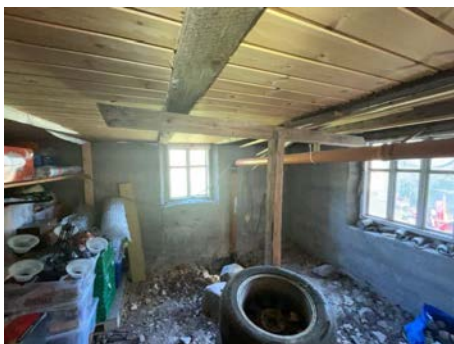
Bilde viser provisorisk/midlertidig bæring i grovkjeller.
