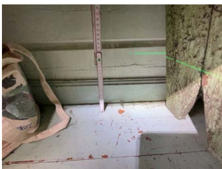
Utkast-strek på laser er 11 cm på målestokk. Bilde viser ca. 9 cm høydeforskjell innenfor 2 meter i gang i 2. etasje.
