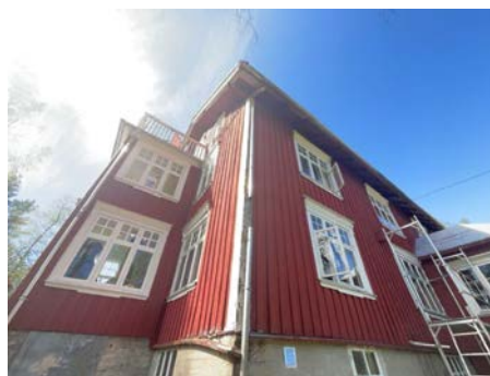
Bilde viser nedløp som er utilstrekkelig festet/montert.
