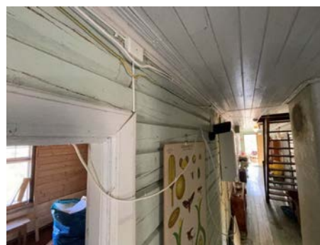
Bilde viser eks. på ledning som er utilstrekkelig festet
