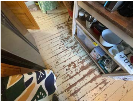
Bilde viser eks. på slitasje på gulv i kjøkken.
