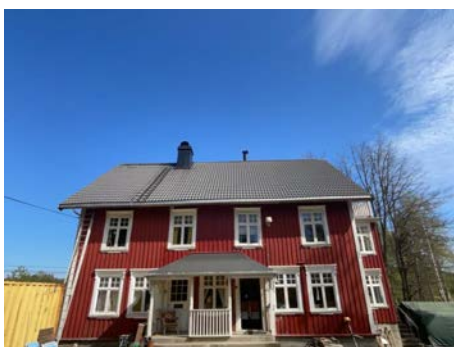
Taket har ikke montert snøfangere.
