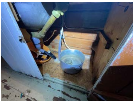
Bilde viser manglende vannlås
