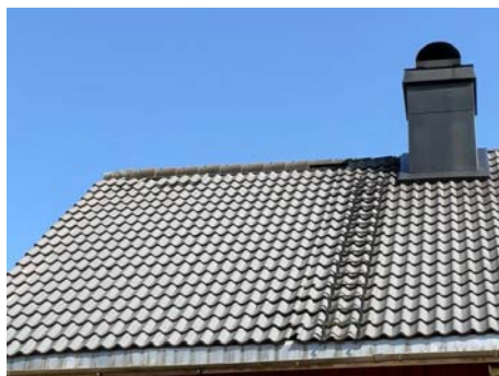
Bilde viser eks. på mangelfull montering av takstein ved møne.
