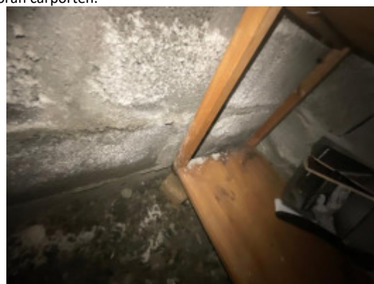
Saltutslag på muren i utvendigbod under carporten.
