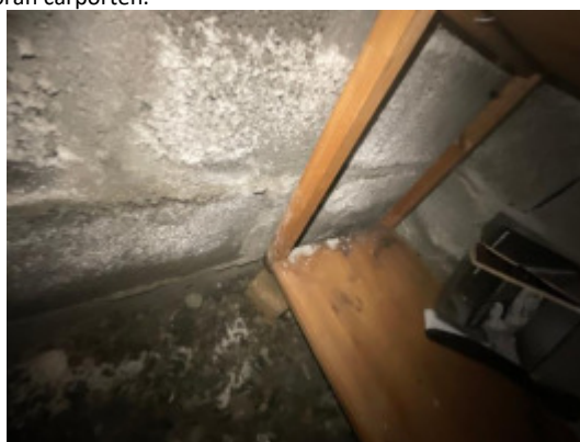
Saltutslag på muren i utvendigbod under carporten.
