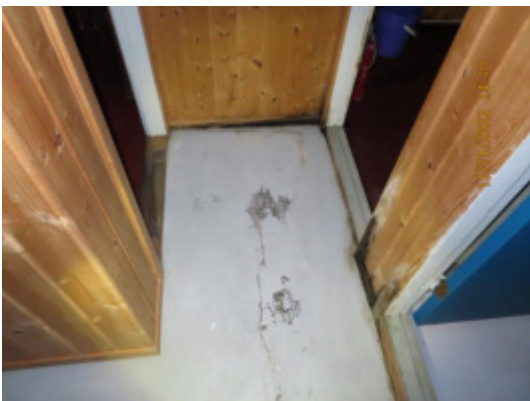
Fuktskadet vegger og gulv i vindfang
