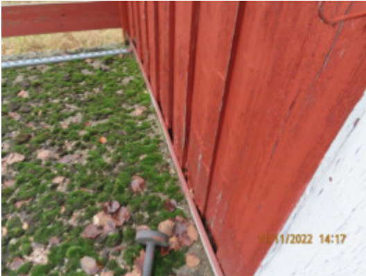
Råteskadet i kledning, ført ned bak verandabeslag
