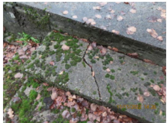
Sprekker og skader i betongtrapp ved veranda
