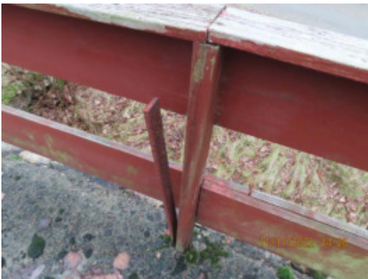
Mangelfull innfesting av rekkverkstolper
