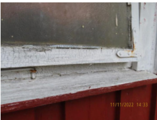
Vindu på bad har råteskade i karm/ramme
