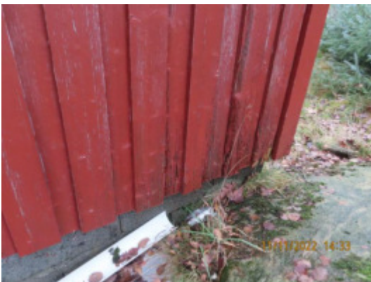
Stedvis omfattende råteskade i kledning
