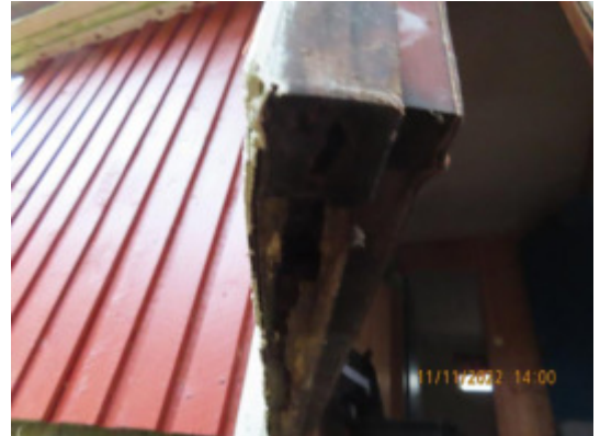
Råteskade på underside av dørbblad ved hovedinngang
