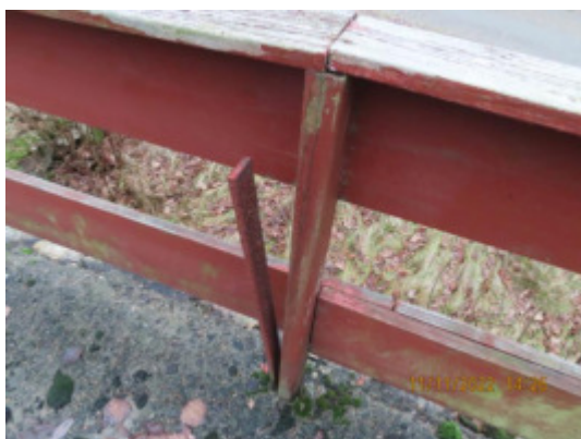
Mangelfull innfesting av rekkverkstolper
