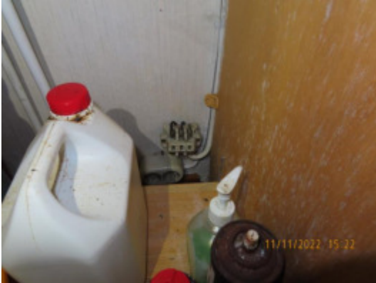
Manglende deksel over kontakt i skap under kjøkkenvask
