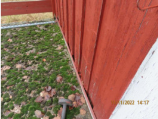
Råteskadet i kledning, ført ned bak verandabeslag
