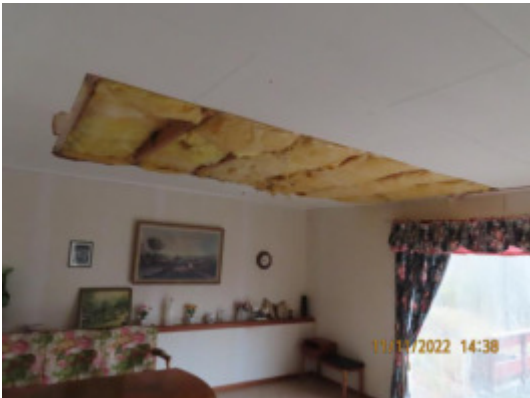
Del av himlingsplater i stue/kjøkken er fjernet
