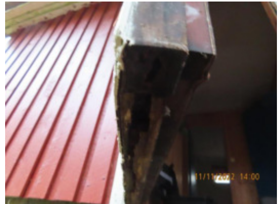
Råteskade på underside av dørbblad ved hovedinngang
