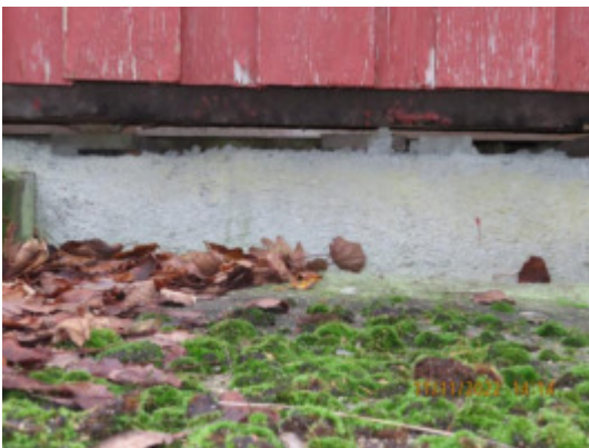
Åpen konstruksjon under kledning, ved oppgang til veranda
