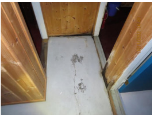
Fuktskadede vegger og gulv i vindfang
