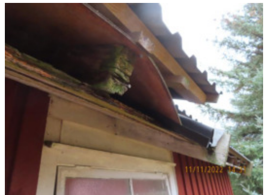
Råteskade i sperre-ende og i gesimspanel
