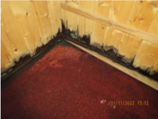
Fuktskadede vegger og gulv i soverom
