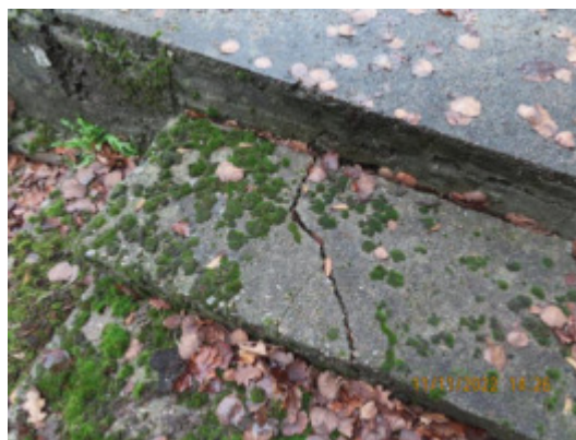
Sprekker og skader i betongtrapp ved veranda
