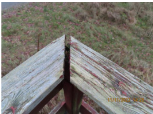
Det er registrert råteskade i rekkverkstolper
