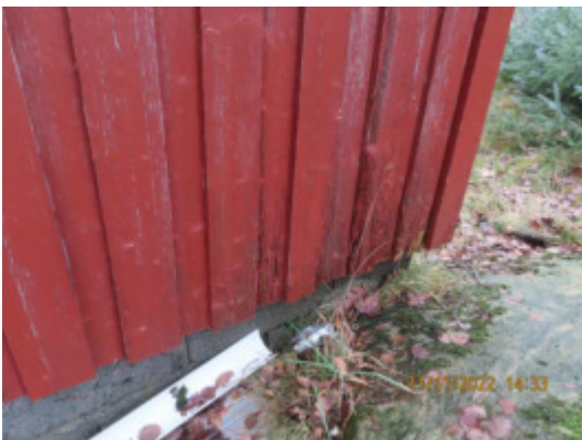
Stedvis omfattende råteskade i kledning
