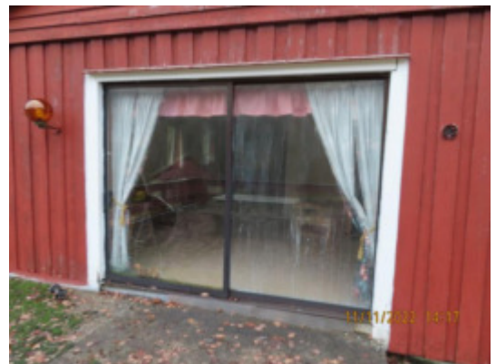
Skyvebalkongdør har knust glass og punktert glass
