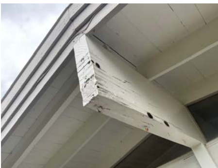
Råteskade i limtre drager.
