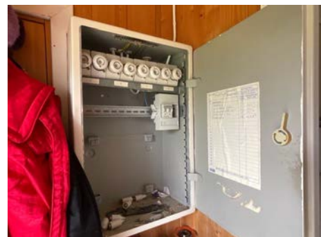
Sikringsskap i utleid del.
