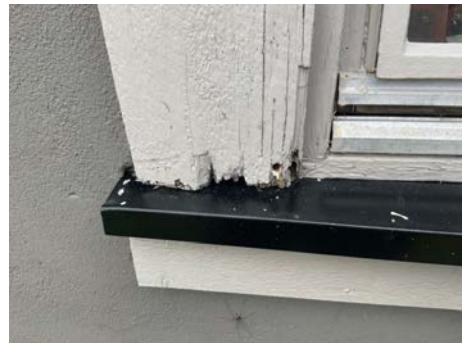
Råteskade i vindusbelistning.
