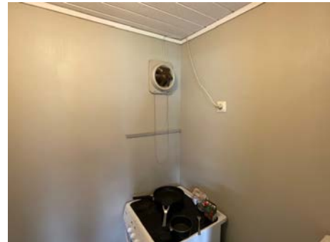
Avtrekksvifte på kjøkken.
