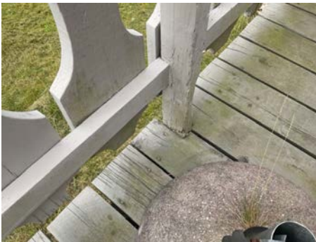
En av flere råteskader.
