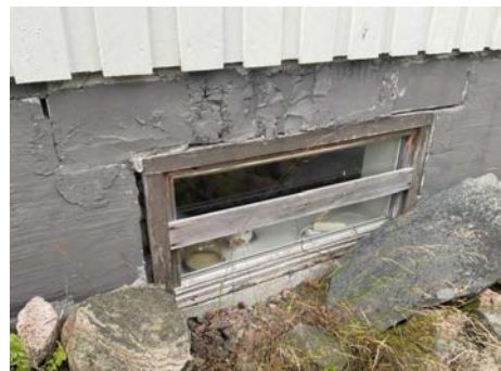
Svak utførelse rundt vindu, fare for vanninntrengning.
