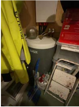
Varmtvannstank på ca. 200 liter.
