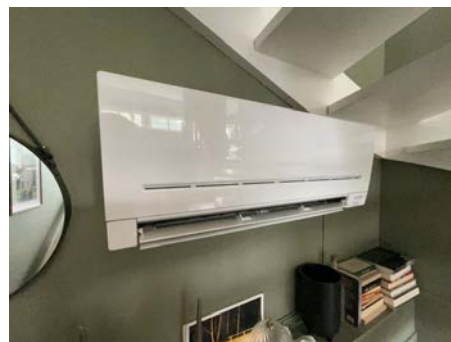
Varmepumpe, innvendig komponent.
