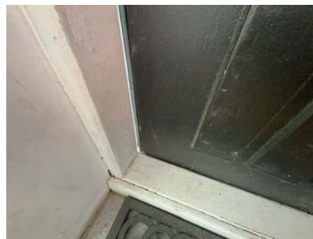
Åpning mellom karm og dør.
