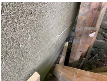
Sprekk og riss i grunnmur.
