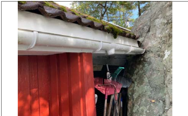
Manglende taknedløp sjøbu
