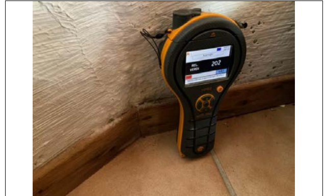
Svake/mindre utslag nedre del av murvegg ved bruk av fuktindikator
