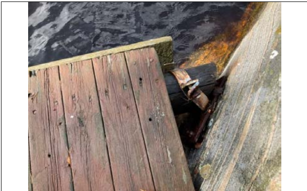
Ytterste del av bryggen hviler på eldre stolpe av treverk. Oppheng/innfesting har synlig rustslitasje
