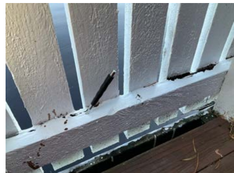
Råte registrert i rekkverk bakside
