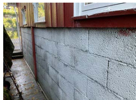
Upusset lecavegg på bakside mot fjell
