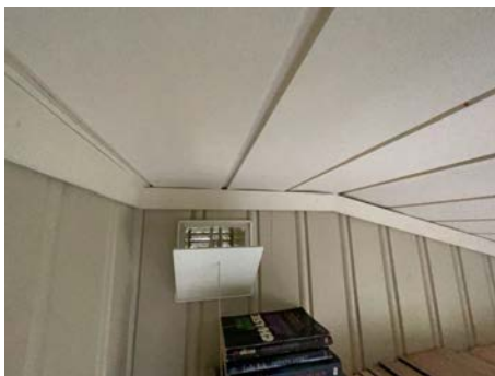
Eksempel på montert ventil i vegg.
