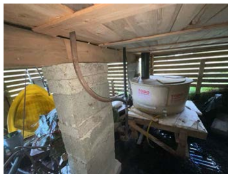
Enkelt avløp under hytten.
