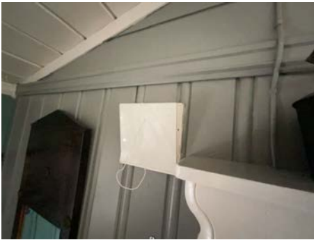
Eksempel på montert ventil i vegg.
