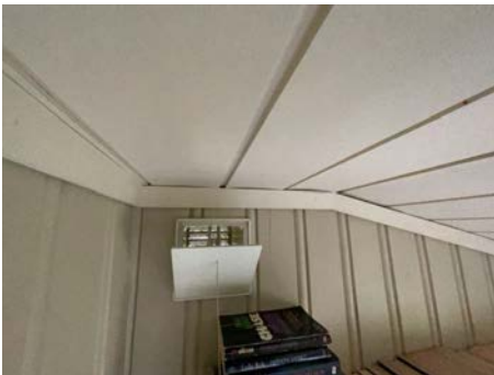
Eksempel på montert ventil i vegg.
