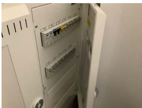
Sikringskap står plassert i bod.
