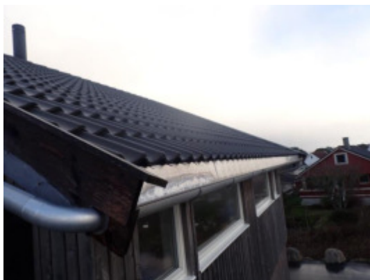
Deler av taket har ikke snøfanger
