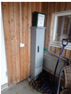
Utvendig skal for strømmåler og inntak
