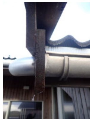
Utradisjonell løsning i sammenføyning med lekkasje
