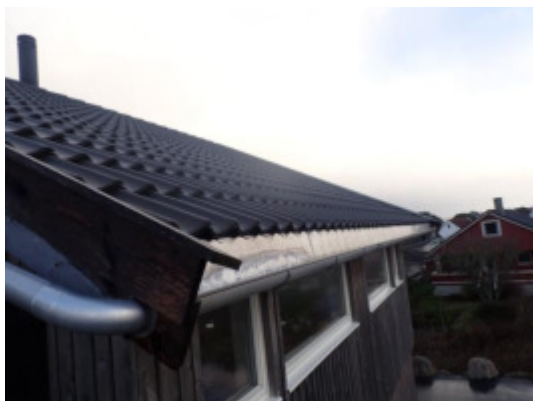
Deler av taket har ikke snøfanger
