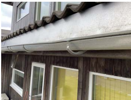
Skade på renne og krok
