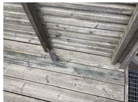
Råteskader i rekkverkstolpe
