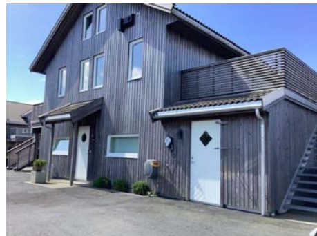
Mangler snøfanger ved inngang
