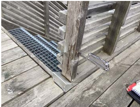
Råteskader i rekkverkstolpe
