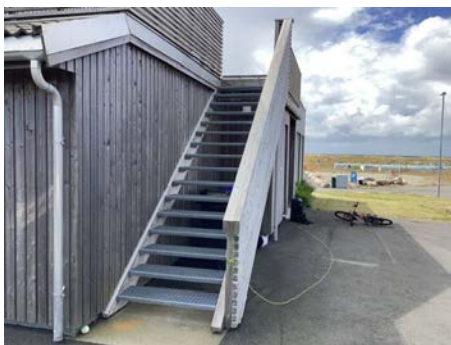
Det mangler håndløper på vegg
