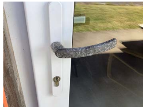
Maling på håndtak har flasket av grunnet værpåkjenninger
