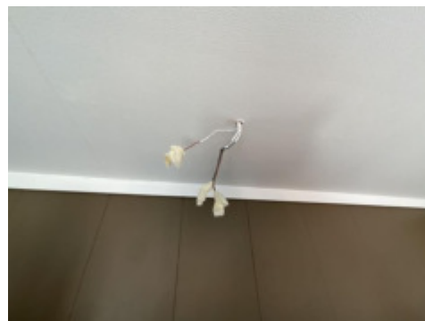
Løse ledninger på kjøkken.
