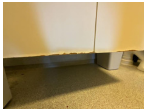
Skader og svelling på innredning.
