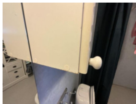
Skader og svelling på innredning.
