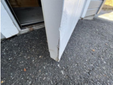
Sprekk og skade på ytterdør mot bod.
