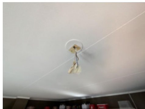
Løse ledninger på kjøkken.
