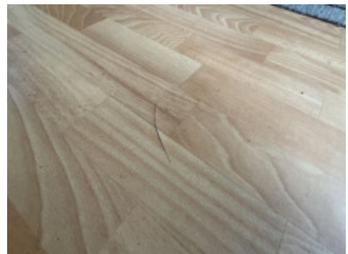
Skade i gulvbelegg.
