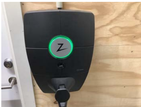
El.bil-lader i parkeringskjeller.
