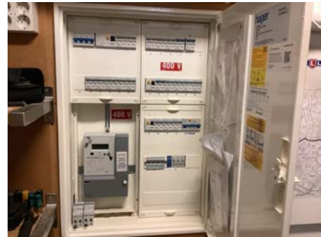
Sikringsskap for selve boligen.
