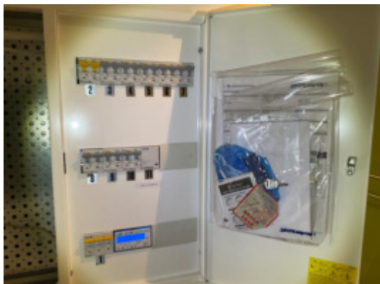
Kursfortegnelse stemmer med antall sikringer
