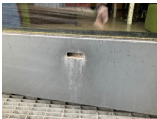
Det mangler to deksler på drenspalter til ytterdøren i stue.
