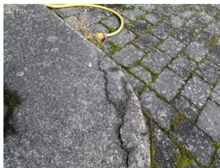
Sprekkdannelse i trapp
