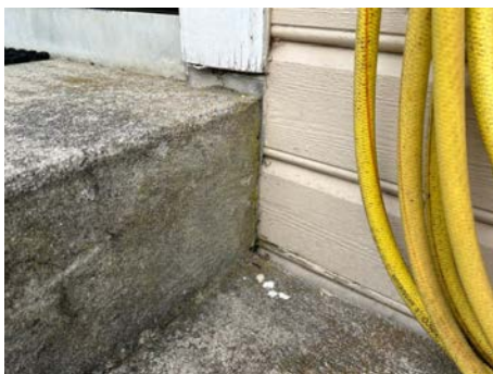
Kledning montert helt inntil annen konstruksjon
