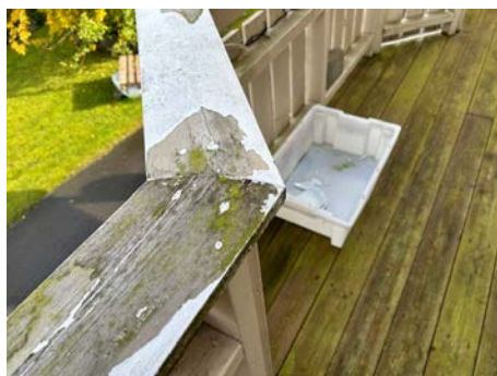
Løs maling og stedvis mykt treverk på rekkverket
