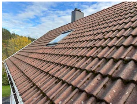
Stedvis noe mose på taksteinene
