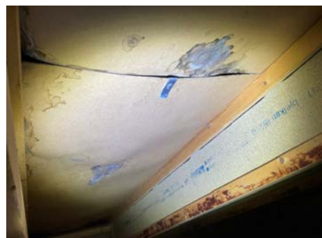
Fuktmerke i undertak.
