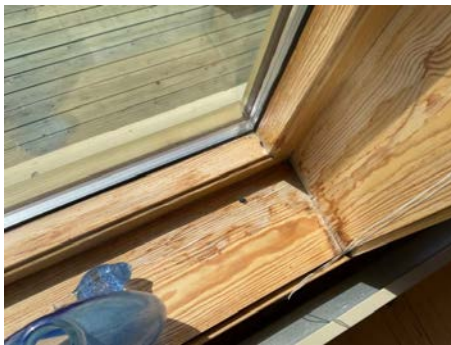
Fuktskade fra da bygget var nytt.
