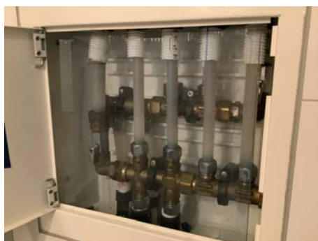
Kontrollskap for røropplegget.
