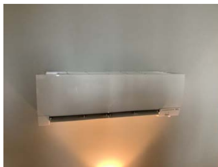
Innerdel til varmpumpe står montert i trapperom.
