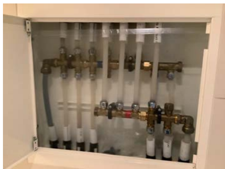
Kontrollskap for rørapplegget.
