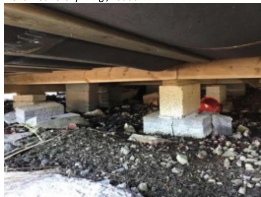
Fundamenter med setningssprekker.
