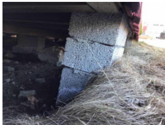
Fundament med forskyvning / loddavvik.
