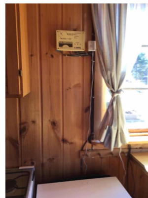
Innvendig styringsenhet i kjøkken.
