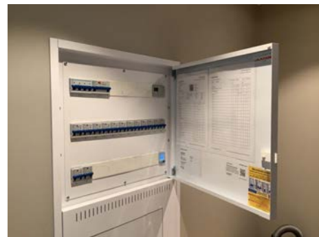
Sikringsskap i hoveddel.
