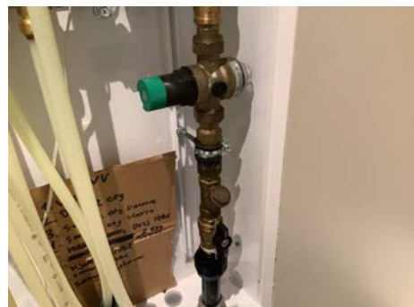
Innvendig stoppekran i rørskapet.
