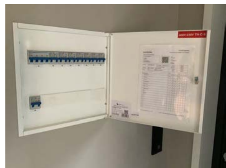
Sikringsskap i praktikantdel.
