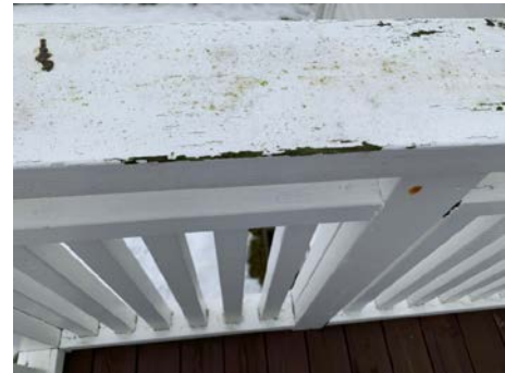
Litt flass etc. på topprekke, normal værslitasje
