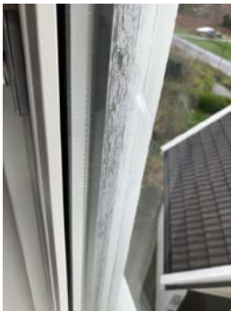
Noe værslitasje på utvendige glasslister på skråvinduer på loftet.
