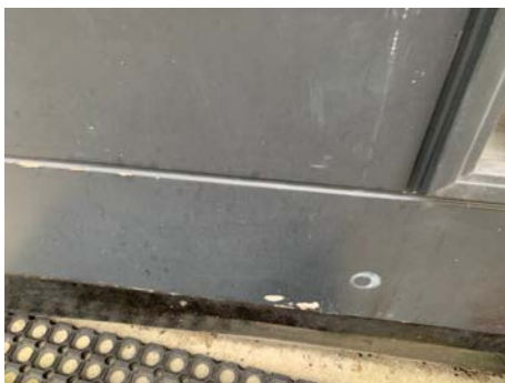
Inngangsdøren har noen merker i dørbladet utvendig.
