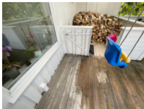
Kort avstand mellom terrassebord og kledning
