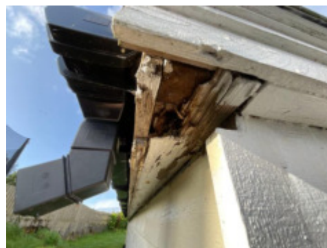
Råteskader i gesims
