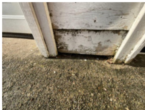
Mykt treverk i nedre del av kledning ved garasjen
