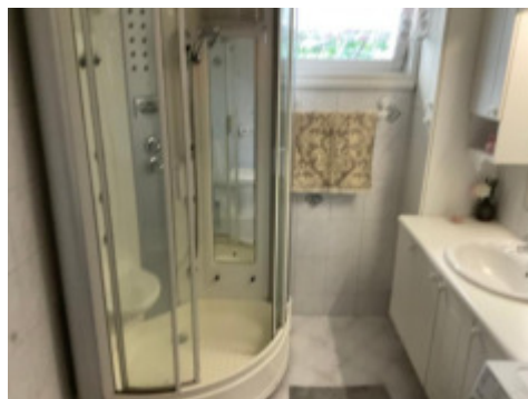
Stor steamdusj montert på bad
