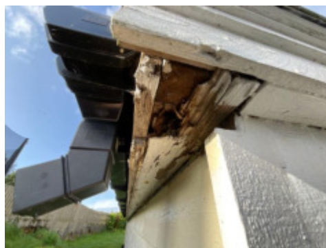
Råteskader i gesims
