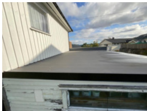
Tak over garasje
