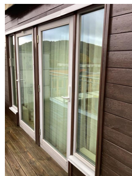
Balkongdør henger og må justeres
