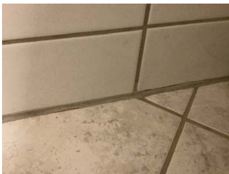
Mykfuger er monden for utskiftning
