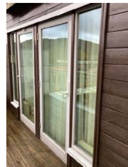
Balkongdør henger og må justeres
