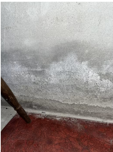
Saltutslag på yttervegger i underetasjen.
