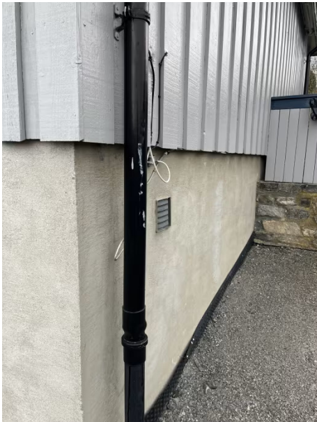
Det mangler 1 meter med klemlist over grunnmursplasten mot hjørne på vest side.
