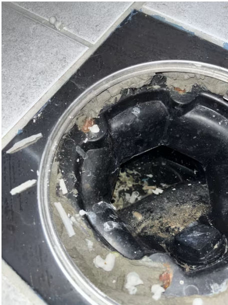
Sluk og membran på toalettet er ikke ikke etter kravene til gjellende regler i NS 3600.
