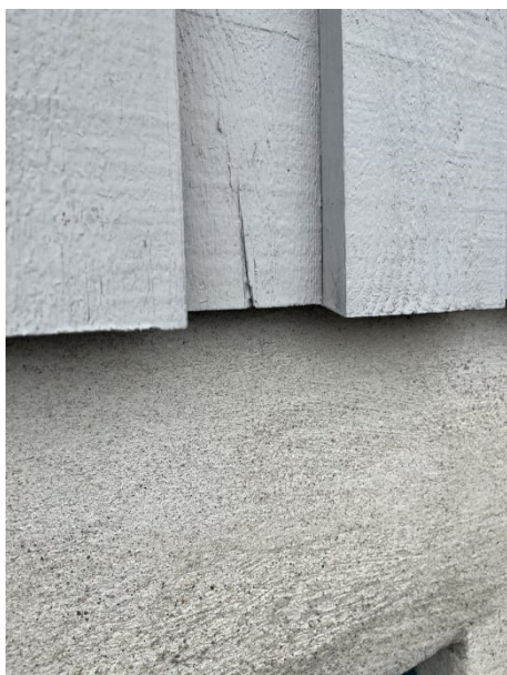
Enkelte sprekkdannelse i utvendig kledning fra byggeår.
