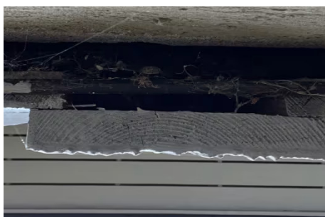
Manglende lufting og musetetting bak kledningen.
