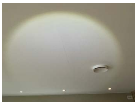
Sprekk i plateskjøt stuetak
