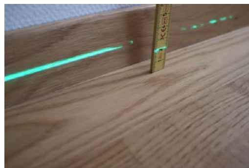
Målt 2 cm retningsavvik i stuen 1.etg.
