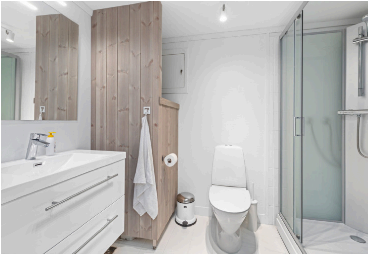
Bad med varmekabler og fliser på gulv
