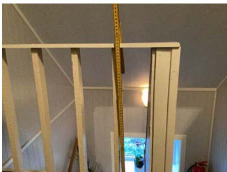
Rekkverk lavere enn dagens krav.
