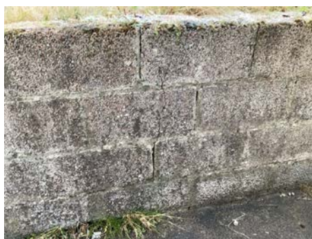
Sprekk i mur bak bolig
