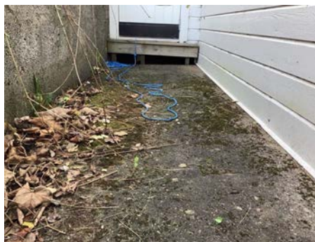
Fall på dekket bak bolig
