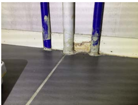
Fug rundt rør, men ingen synlig tegn til membran
