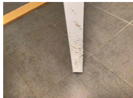
Slitasje dør vaskerom
